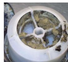
Zentrifugentrommel, durch Schlamm in der Leistung beeinträchtigt
